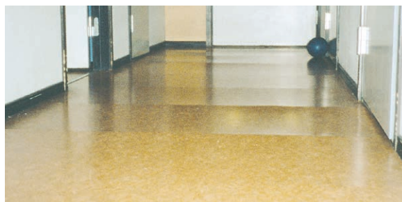
Fukt har trängt igenom den underliggande folien och har medfört att spånskivan svällt, nedbrytning av lim och blåsbildning på mattan.
