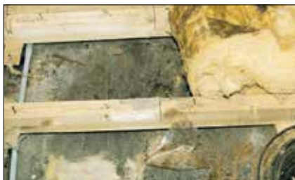
Fukt från mark har trängt igenom betongen/ plastfolien och orsakat mögeltillväxt.
