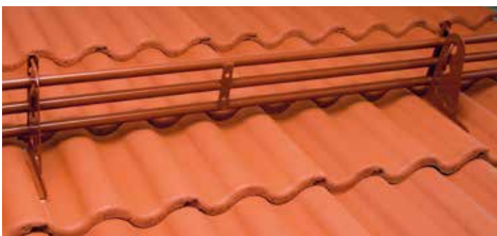
Bild 20. Snörasskydd grind komplett monterad på tak.
